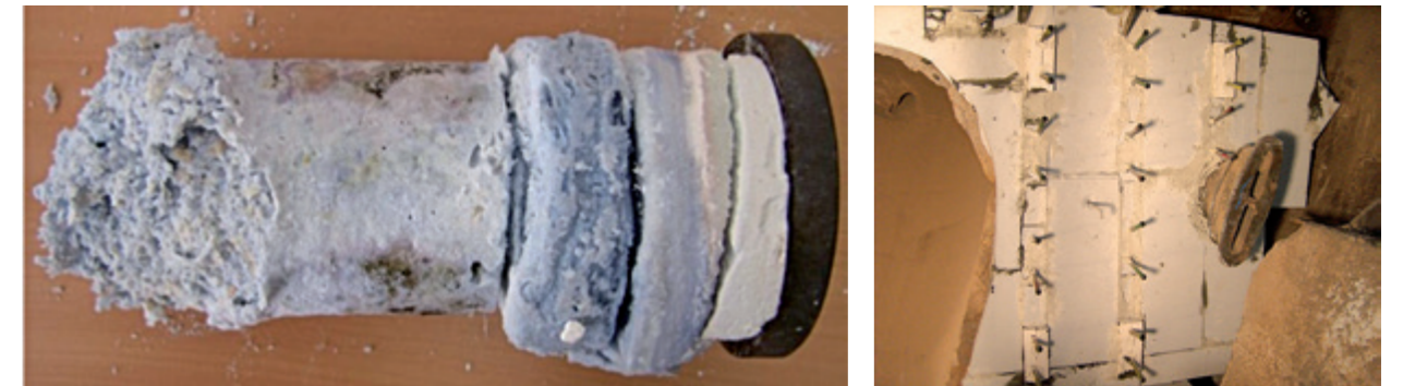
Abbildung 4.1.2.1 Links: Unbeständiges Auskleidungssystem bestehend aus (von links nach rechts) Feuerbeton, Wärmedämmschicht, Außenblech. Rechts: Beständiges Auskleidungssystem zu Projektende
